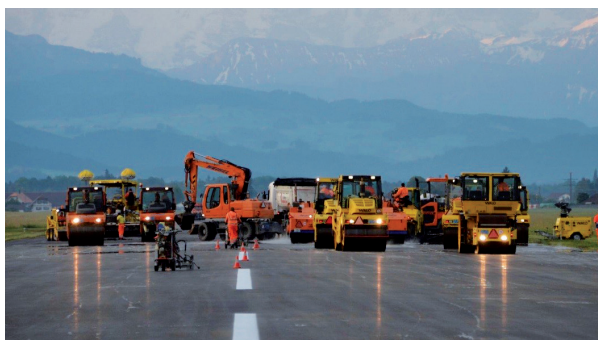
Dank der Zugabe von 0,35 Prozent «Cecabase RT BIO 10» konnte die neue Piste um 5 Uhr morgens wieder zur Nutzung freigegeben werden.
